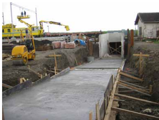
Právě vybetonovaná podlaha rampy podchodu. Vozidlo na trati je montážní vůz trakčního vedení PS-00.M-20. {7.5.2006}
